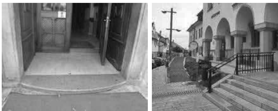
Obr. 1: Vľavo – Zdvihnutá nová podlaha v dverách historického kostola. Ide o nekoordinované riešenie preferujúce jednoduchosť technickej realizácie voči pamiatkovému aj bezbariérovému hľadisku. Foto B. Polomová, Vpravo – Príklad dodatočnej vhodnej úpravy pre bezbariérový vstup. Foto K. Macháčová.
