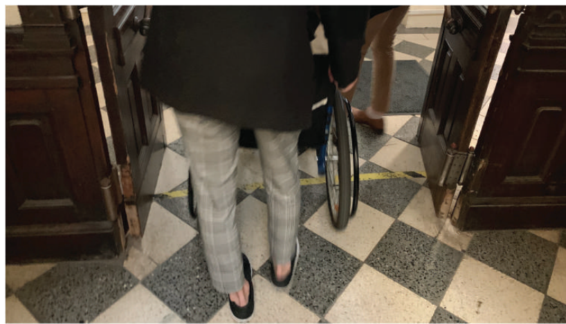
INTERIÉROVÉ DVERE_ NEDOSTATOČNÁ SVETLÁ ŠÍRKA DVERNÉHO KRÍDLA STAŽUJE VSTUP OSOBN NA INVALIDNOM VOZÍKU
