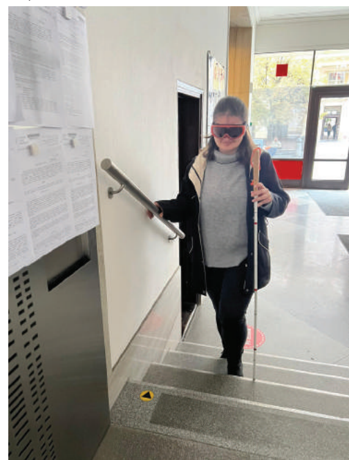
výstup po schodisku s pomocou madla zábradlia, pre slabozrakých nedostatočné označenie stupňov schodiska
