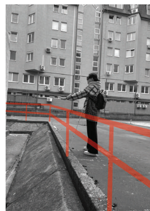
CHÝBAJÚCE ZÁBRADLIE PRI VYVÝSENEJ PLOCHE
