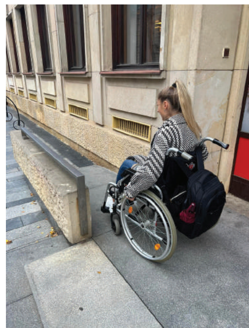
bezbariérový hlavný vstup do budovy, zábradlie nespĺňa legislatívne požiadavky
