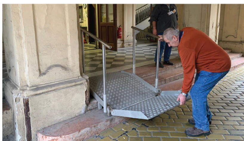
VSTUP DO BUDOVY_ NEMOŽNOSŤ VYUŽITIA SKLÁPACEJ RAMPY BEZ POMOCI DALŠEJ OSOBY
