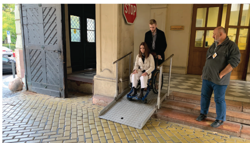
SKLÁPACIA RAMPa_ NEVHODNÝ SKLON A UMIESTNENIE RAMPY JE NEBEZPEČNÉ PRE OSOBY NA INVALIDNOM VOZÍKU, NÁSTUP NA RAMPU JE NA CESTE
