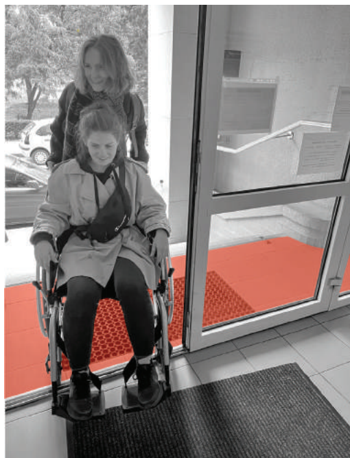
NEDOSTATOČNÁ HĽBKÁ PODESTY PRE MANIPULÁCIU S VOZIČKOM
